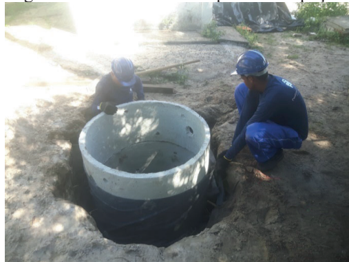
Figura 10 - Operários realizando a colocação da manta geotêxtil externamente as paredes do poço
