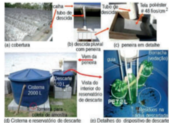
Figura 6 - Sistema experimental de aproveitamento de água de chuva em um galpão com telhado de fibrocimento
