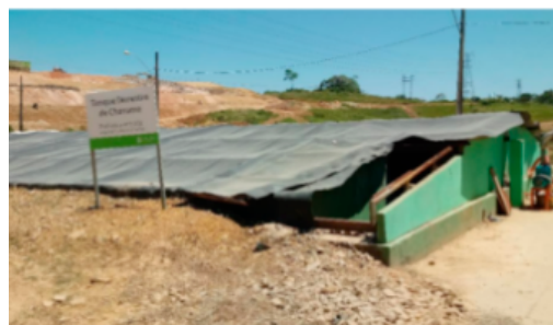
Figura 2 – Tanque de chorume no aterro sanitário da ESTRE em Sergipe
