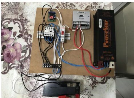
Figura 4 - Automatizador de Sistema de Transferência Solar/Rede elétrica.
