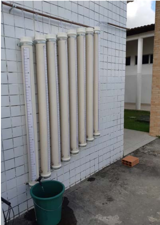
Figura 04 - Sistema instalado e em funcionamento.
