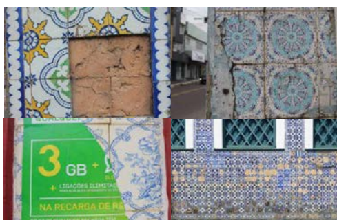
Figura 8 - Degradação dos azulejos em fachadas de Estância.
