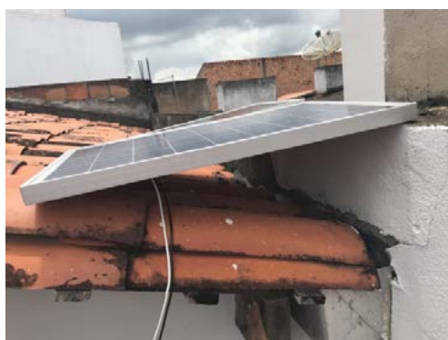
Figura 1 - Painéis de 30 W instalados em paralelo Fonte: Autor, 2019.
