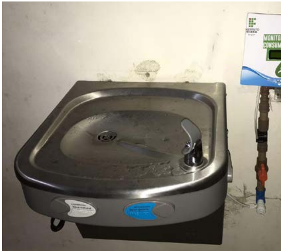
Figura 2 - Protótipo instalado no bebedouro
