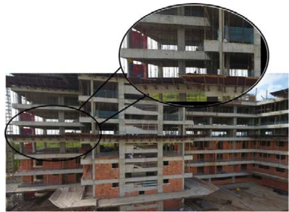
Figura 3 - Vão aberto, sem guarda-corpo.
