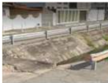
Figura 1 - Ponto de coleta de esgoto doméstico
