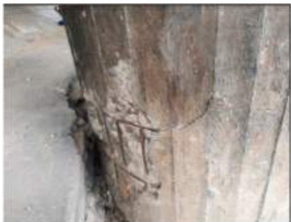
Figura 3 – Exposição de armadura e degradação do pilar Fonte: Autor
